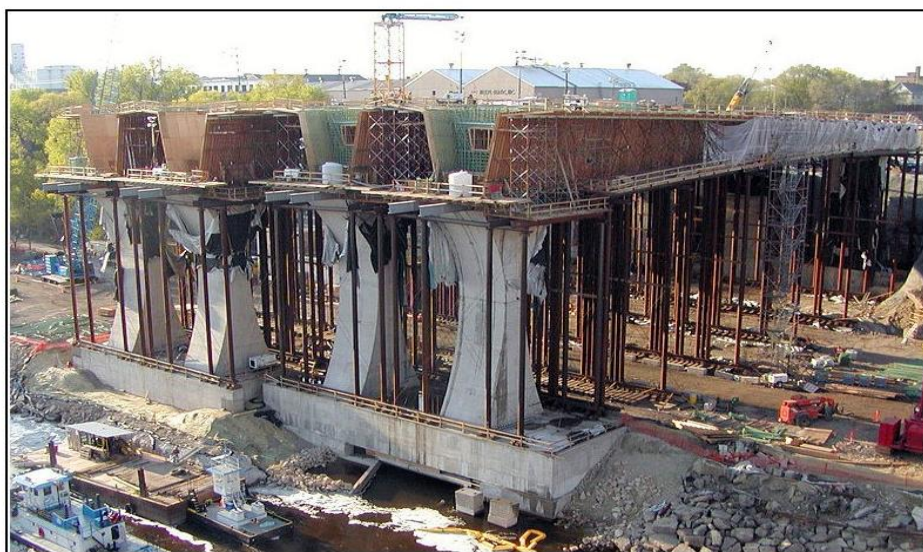
Cầu mới đang xây cất - Cầu được xếp hạng nhất trong các công trình xây cất tại Mỹ năm 2008
