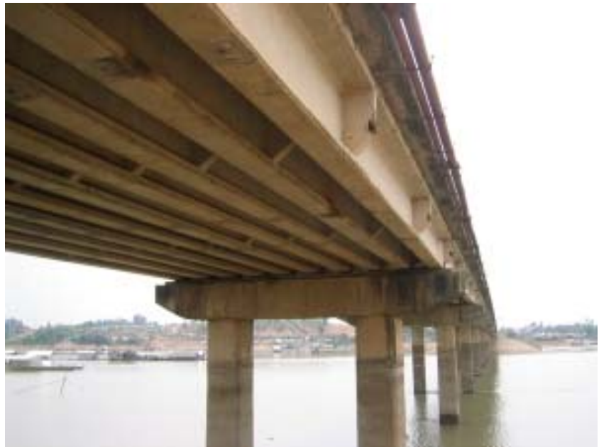
Cầu xây xong là niềm vui của người kỹ sư công chánh
