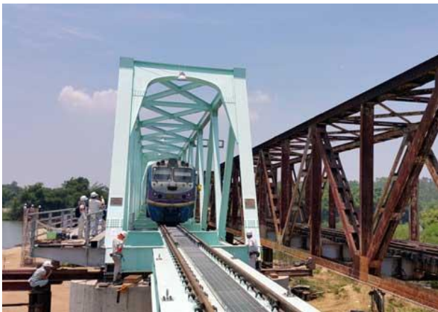
Hình ảnh tiêu biểu của một chiếc cầu sắt được sửa chữa năm 1975 (mặt), và chiếc cầu mới được xây dựng kế bên vào năm 2015 (trái)
